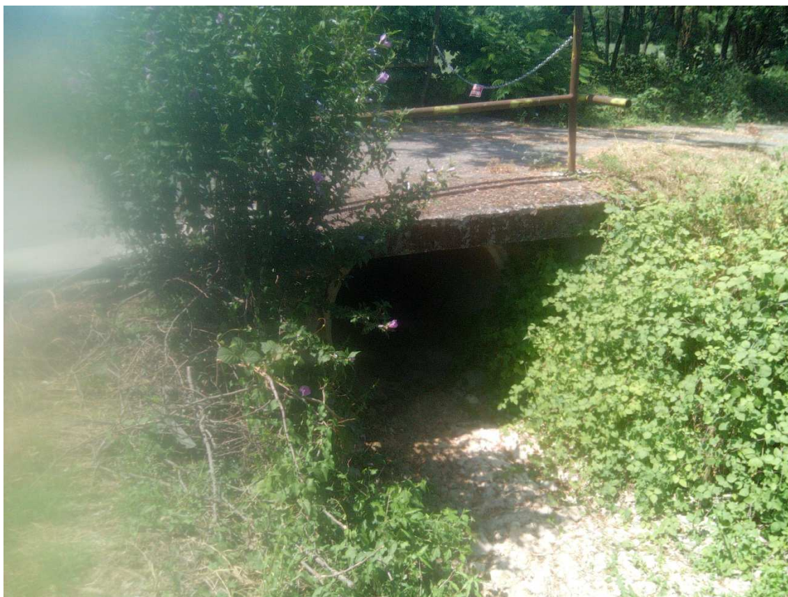
Figura 6.1 Attraversamento del Torrente Miola in Via del Pomo: tubazione in CLS DN 1'400 mm
