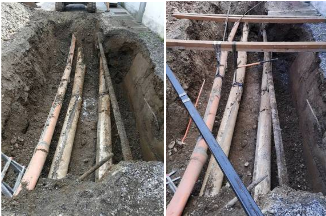
Fig. 9 Linea pluviali danneggiata
